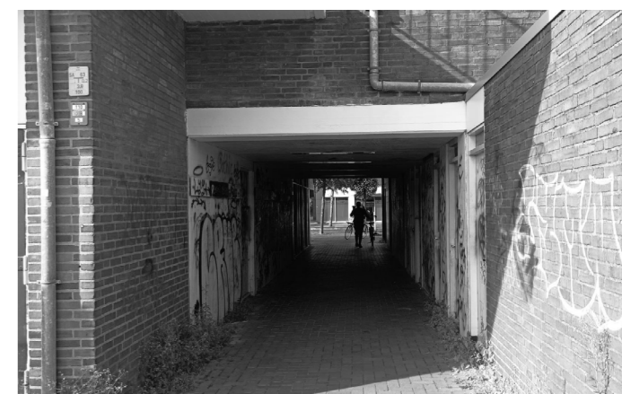
Afbeelding 84: Conditie van verbindingsgang
